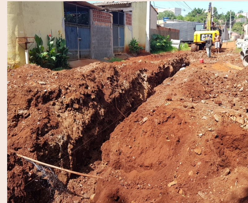
Projetos da rede antiga fornecidos pela Sanepar divergentes da realidade local
